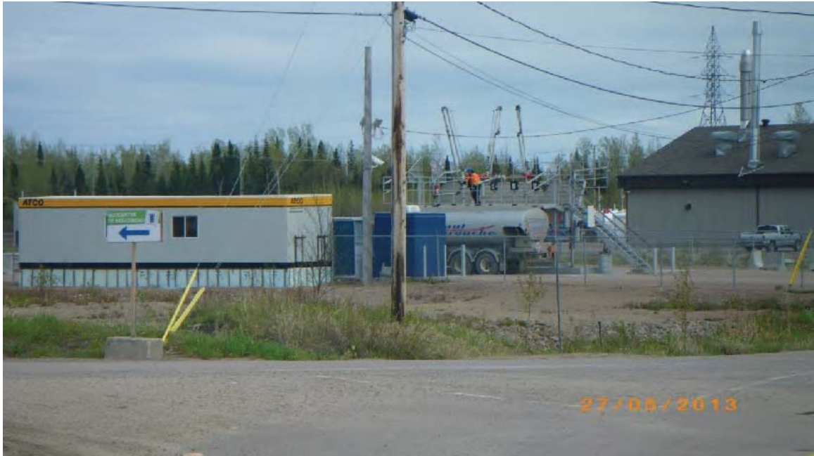
Photo 1 : Vue vers l'est. Entreposage et/ou équipement de distribution d'hydrocarbures et activité désignées à l'Annexe III du RPRT (Distribution Nord)
